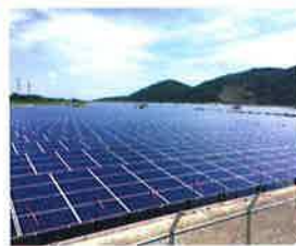
富津ソーラー発電所
